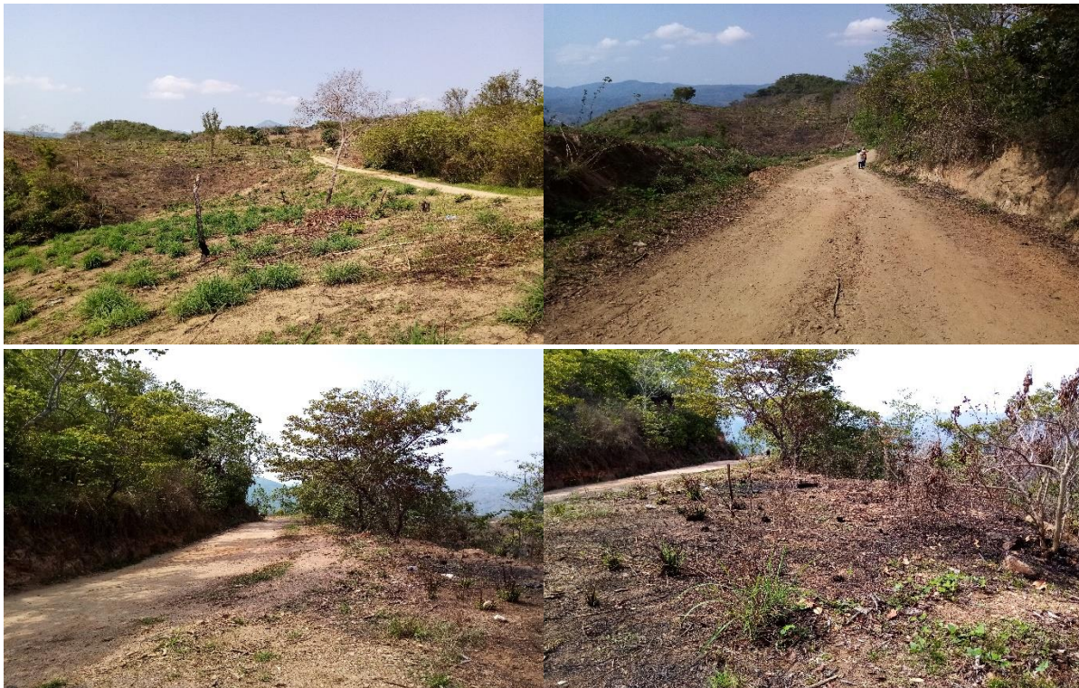
Figura VIII.6. Vista general de áreas desprovistas de vegetación a los costados del camino actual.
