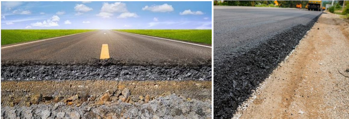
Figura II.22. Vista general de carpeta de concreto asfáltico a construir en el camino.
