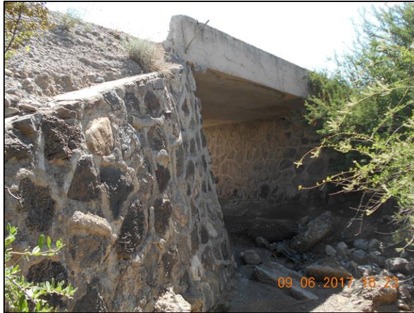
Figura VI.36 Ejemplo de una obra de drenaje adaptada como paso de fauna silvestre en una obra similar.
