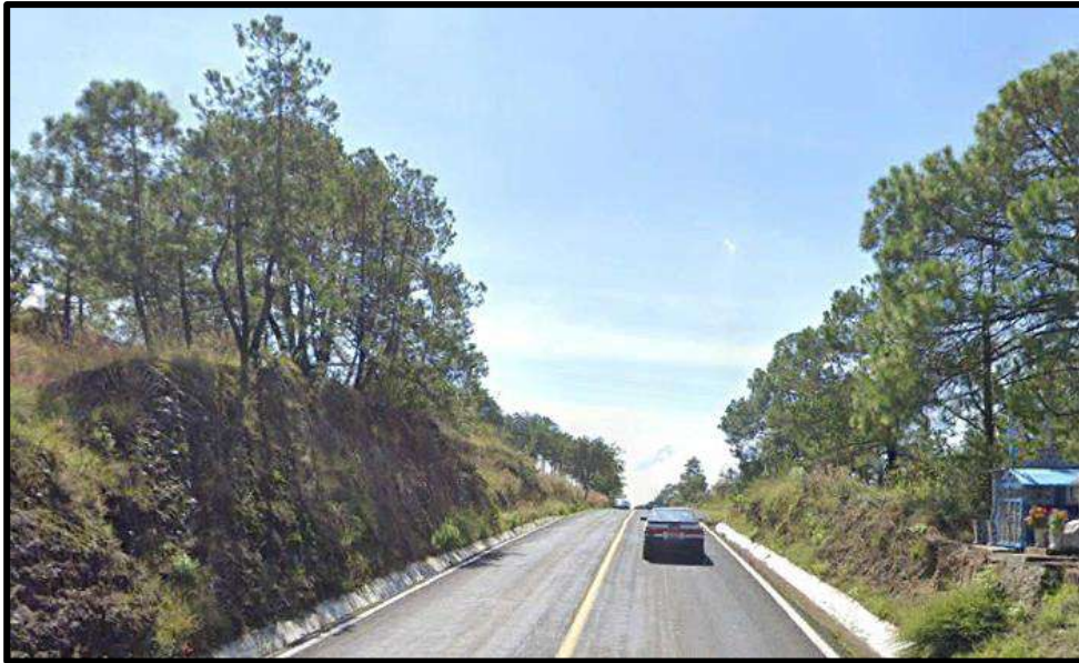
Figura IV.40 Zona del tramo 89+260.00 al 89+380.00, donde se observa una pendiente lateral con una altura de 3.5 m y donde se proyecta la construcción de un muro.
