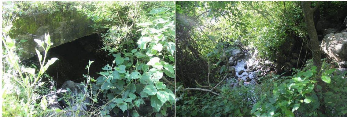
Figura 59. Obra de drenaje en el km 5+797.17 con vegetación secundaria de selva baja caducifolia.
