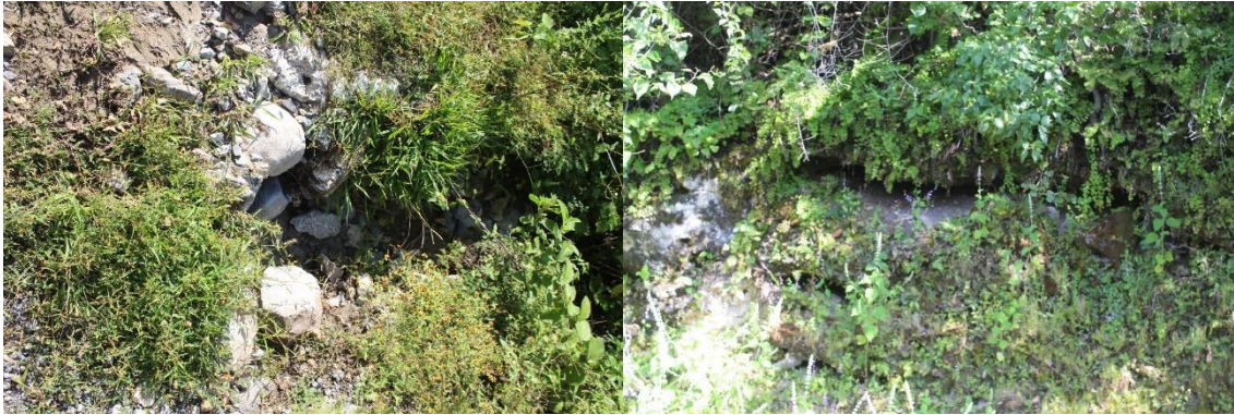
Figura 55. Obra de drenaje en el km 4+248.61. En ambas fotografías se observa que se encuentra obstruida y azolvada por rocas.
