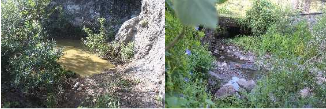
Figura 7. Fotografías actuales de las obras de drenaje azolvadas.
