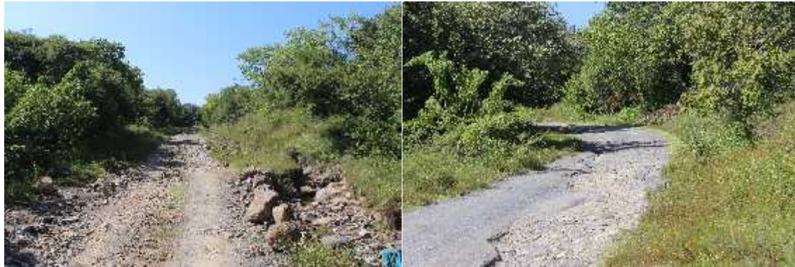
Figura 3. Condiciones actuales del camino, imagen izquierda km 0+811.90 e imagen derecha 0+874.35.
