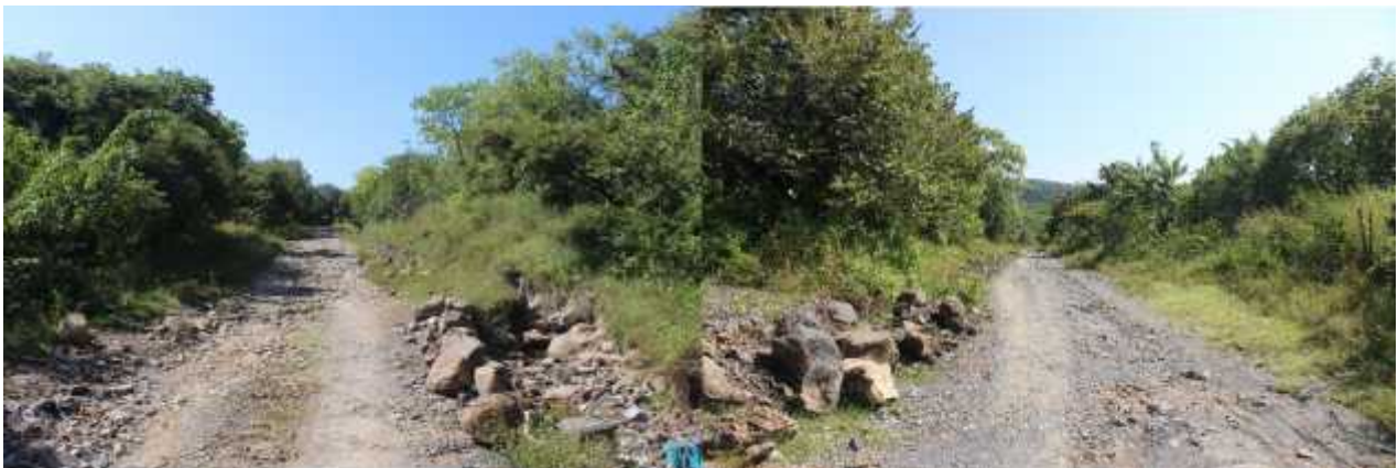
Figura 4. Se observan las condiciones de la carretera actual. Estas condiciones se incrementan en temporada de lluvias, lo cual dificulta el tránsito y lo vuelve inseguro.
