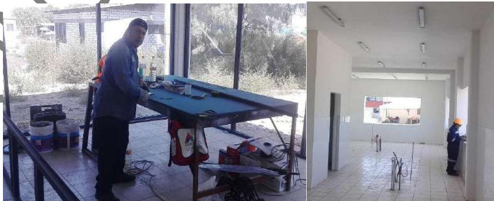
Foto II. 10. Ejemplo de instalación de cancelería, vidriería e instalación eléctrica, vos y datos.
