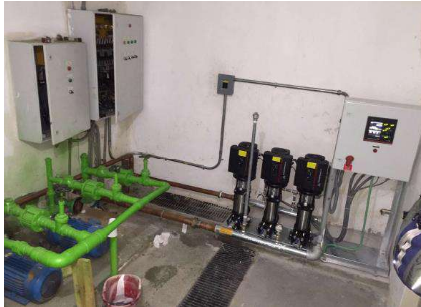
Foto II. 19. Ejemplo de Sistema hidroneumático tipo Boosterpaq.
