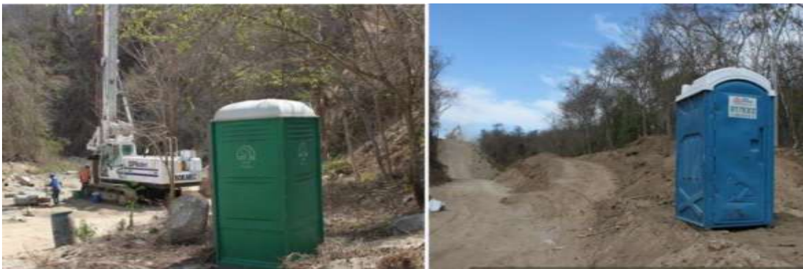
Figura 5. Ejemplo de la utilización de sanitarios portátiles en la construcción de proyectos similares
