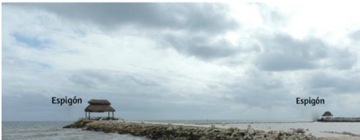
Figura 38. Espigones construidos en diferentes años en la zona marina dentro del Sistema Ambiental Regional del proyecto (noviembre 2018). Fotografías: C. Delgado.
