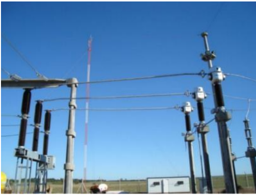
Transformador de corriente
