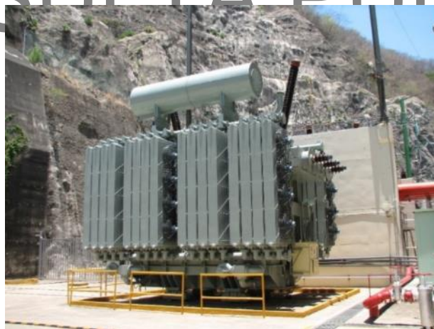
Figura II-64 Transformador de potencia
