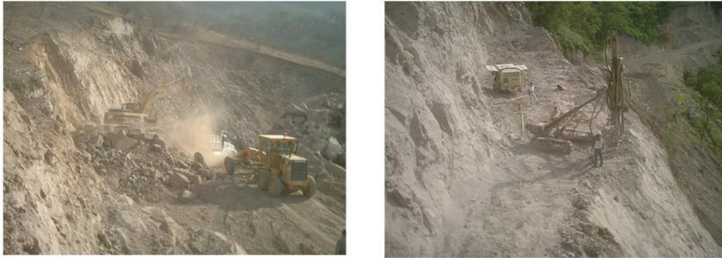
Figura II-78. Carga de material producto de excavación con maquinaria y uso de explosivos para llegar a nivel de terracerías (izquierda); Barrenación para excavación con uso de explosivos (derecha).
