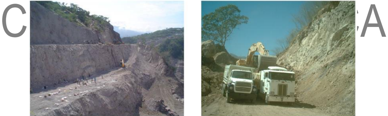
Figura II-79. Carga de barrenos con explosivos (izquierda); Carga y acarreo de material producto de excavación (derecha).
