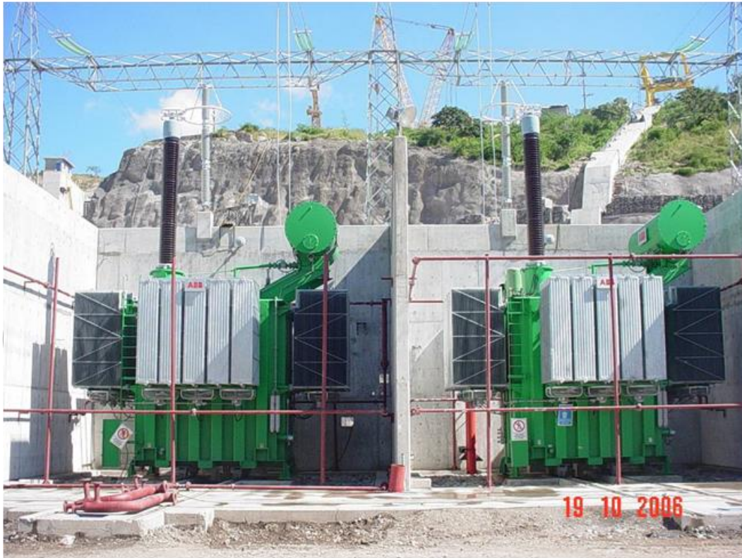
Figura II-61. Transformadores de potencia y equipos exteriores de la subestación.
