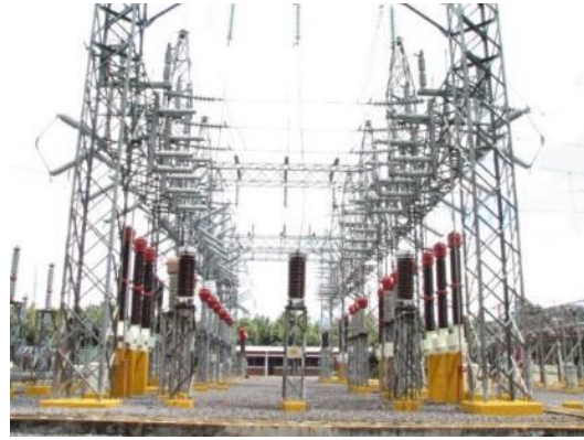
Transformador de potencial
