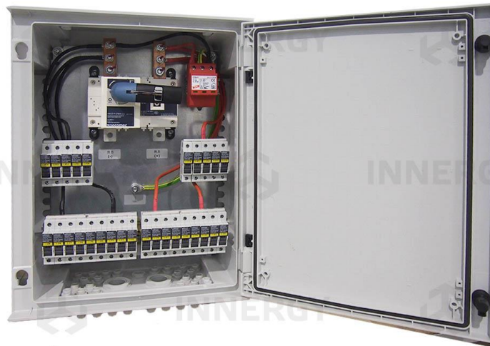
Figura II.7 Tipo de Combiner box
