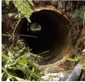
Obra de drenaje ubicada en Km 6+781.968 lado derecho del camino, construida a base de tubería de acero de 91 cm, la cual no presenta obstrucción en su área hidráulica.
