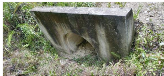
Obra de drenaje ubicada en Km 5+737.026 lado izquierdo del camino, construida a base de tubería de concreto de 91 cm, la cual presenta una obstrucción del 10% de su área hidráulica
