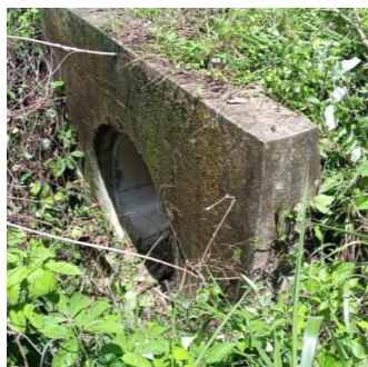
Obra de drenaje ubicada en Km 7+970.403 lado derecho del camino, construida a base de tubería de concreto de 91 cm, la cual no presenta obstrucción en su área hidráulica
