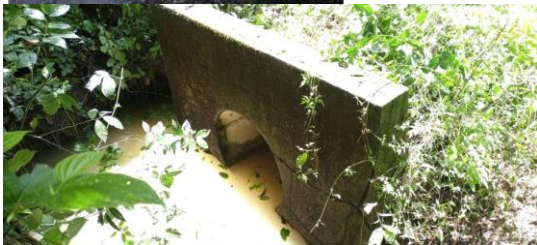
Obra de drenaje ubicada en Km 4+451.688 lado derecho del camino, construida a base de tubería de concreto de 91 cm, la cual presenta una obstrucción del 15% de su área hidráulica, producto de agua estancada.
