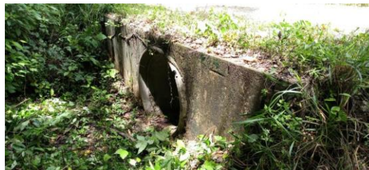
Obra de drenaje ubicada en Km 4+600 lado izquierdo del camino, construida a base de tubería de concreto de 91 cm, la cual presenta obstrucción en su área hidráulica.
