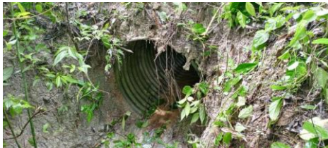
Obra de drenaje ubicada en Km 6+010.508 lado derecho del camino, construida a base de tubería de acero de 91 cm, la cual no presenta obstrucción en su área hidráulica
