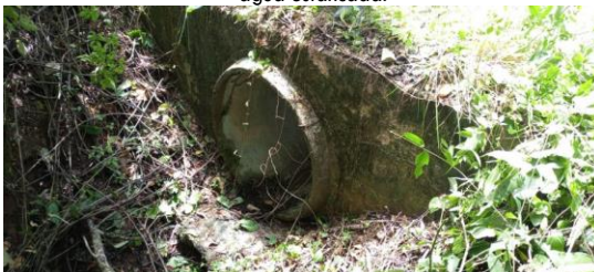
Obra de drenaje ubicada en Km 4+600 lado derecho del camino, construida a base de tubería de concreto de 91 cm, la cual no presenta obstrucción de su área hidráulica.
