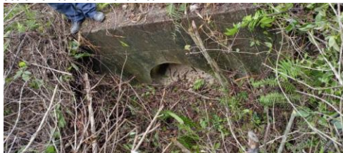
Obra de drenaje ubicada en Km 5+783.236 lado derecho del camino, construida a base de tubería de concreto de 91 cm, la cual presenta una obstrucción del 70% de su área hidráulica, producto de asolvamiento
