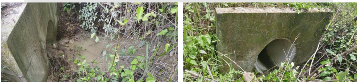
Obra de drenaje ubicada en Km. 1+005.414 lado izquierdo del camino, construida a base de tubería de concreto de 91 cm, la cual presenta una obstrucción del 0 % de su área hidráulica, No presenta deterioro en el cabezote sin embargo la tubería si presenta deterioro.
