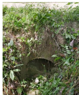
Obra de drenaje ubicada en Km 7+970.403 lado izquierdo del camino, construida a base de tubería de concreto de 91 cm, la cual presenta una obstrucción del 35% de su área hidráulica
