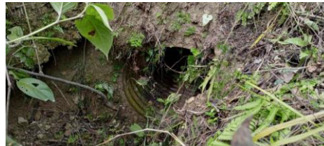
Obra de drenaje ubicada en Km 6+010.508 lado izquierdo del camino, construida a base de tubería de acero de 91 cm, la cual no presenta obstrucción su área hidráulica.
