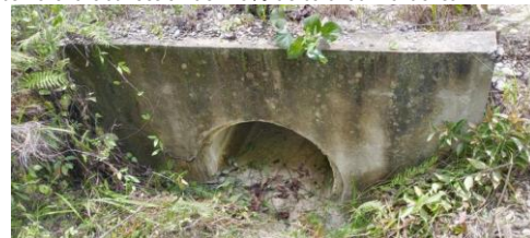
Obra de drenaje ubicada en Km 5+783.236 lado izquierdo del camino, construida a base de tubería de concreto de 91 cm, la cual presenta una obstrucción del 20% de su área hidráulica
