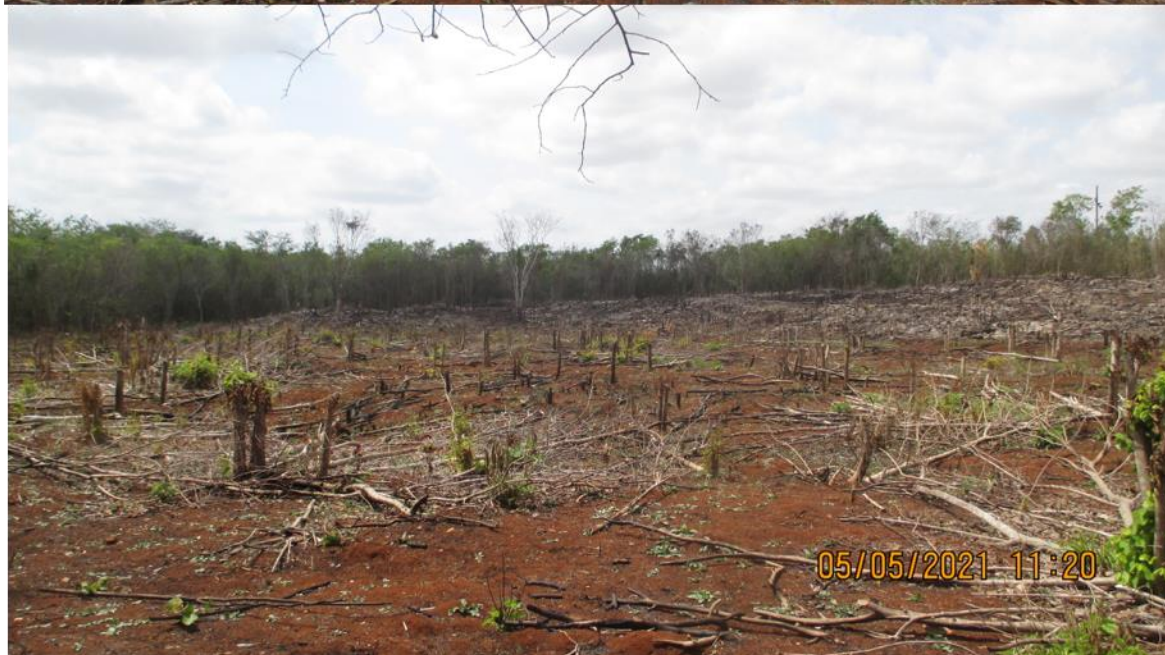
FIGURA II-21 SITIO PARA PATIO DE MANIOBRAS PARA LA TERCERA ETAPA CORRESPONDIENTE AL TRAMO DEL KM 004+080 AL KM 006+120
