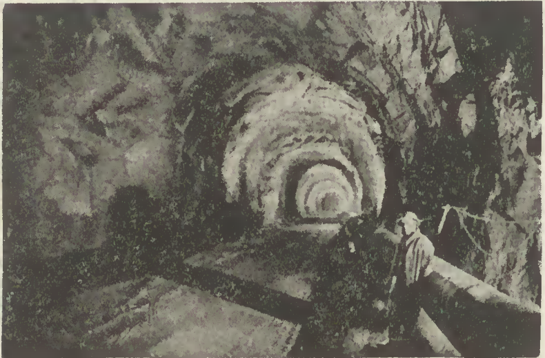
Túnel de restituição das águas turbinadas na Caniçada que tem como função permitir o escoamento para o Cávado dessas águas na central subterrânea. Mediante esta técnica foi possível situar a central 50 metros sob o leito do rio, aumentando da mesma quantidade a queda bruta disponível
