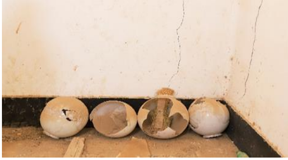
(صورة ٢٠) توضح الشقوق في الجدران. أيضا تراكم الانساختات علي الأرضية الزجاج المحطم وهو مسجل في الآثار. والشروخ المنتشرة علي الجدران الداخلية للقبة.
