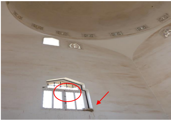
(صورة ١٦) توضح الشباك في الجدار المقابل وأعشاش الطيور الفضلات والاتساخات وكسر الشباك الزجاجي.
