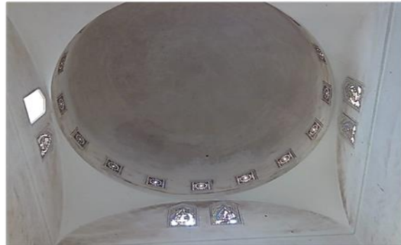
(صورة ١٧) توضح الشبائيك في الصف الأول بالقبة. ويتضح فقد أجزاء من الشباك نتيجة بسبب الطيور. يوجد عدد ١٦ نافذة تتخذ شكل المربع. نلاحظ التصاق الأتربة علي جدران القبة من الداخل، والفقد النهائي لأحد الشبائيك الجصية © تصوير الباحث.
