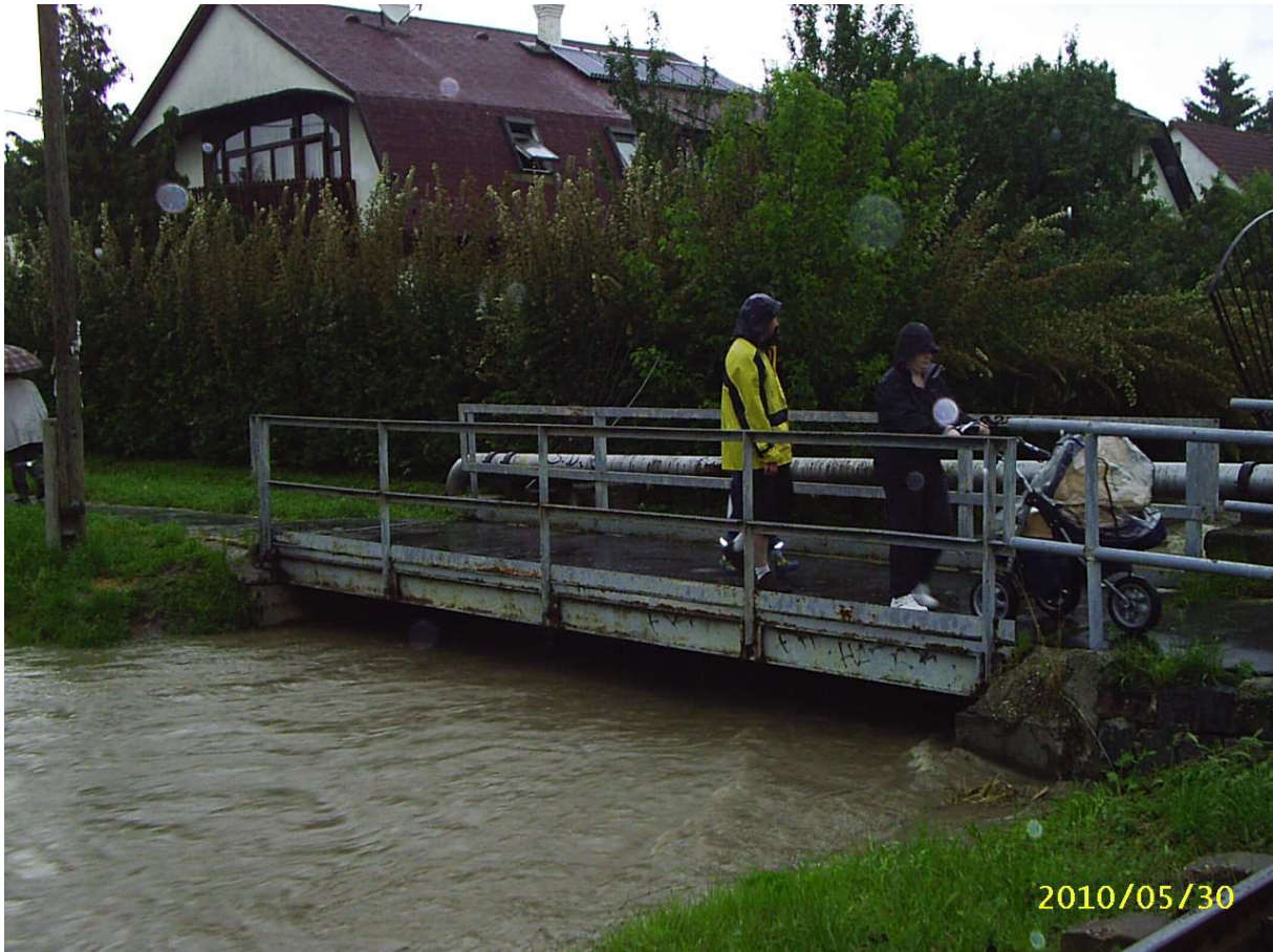
45. ábra: A Híd utcai gyaloghíd, amely alatt a patak kiöntés nélkül haladt át (forrás: FCSM ZRt.).
