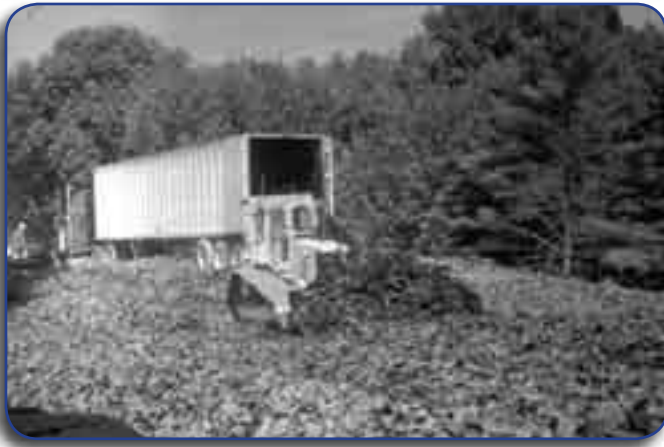
Figura E-2. Oruga Caterpillar D-4 esparciendo el ADL como relleno ligero del terraplén en el Intercambio Vial del Aeropuerto de Portland
