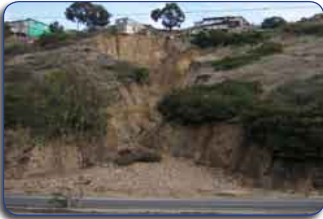
Ejemplo de la erosión que puede presentarse con las condiciones en el norte de México. Foto Cortesía de la Comisión Estatal de Servicios Públicos de Tecate
