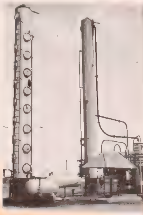
Planta de absorcion
