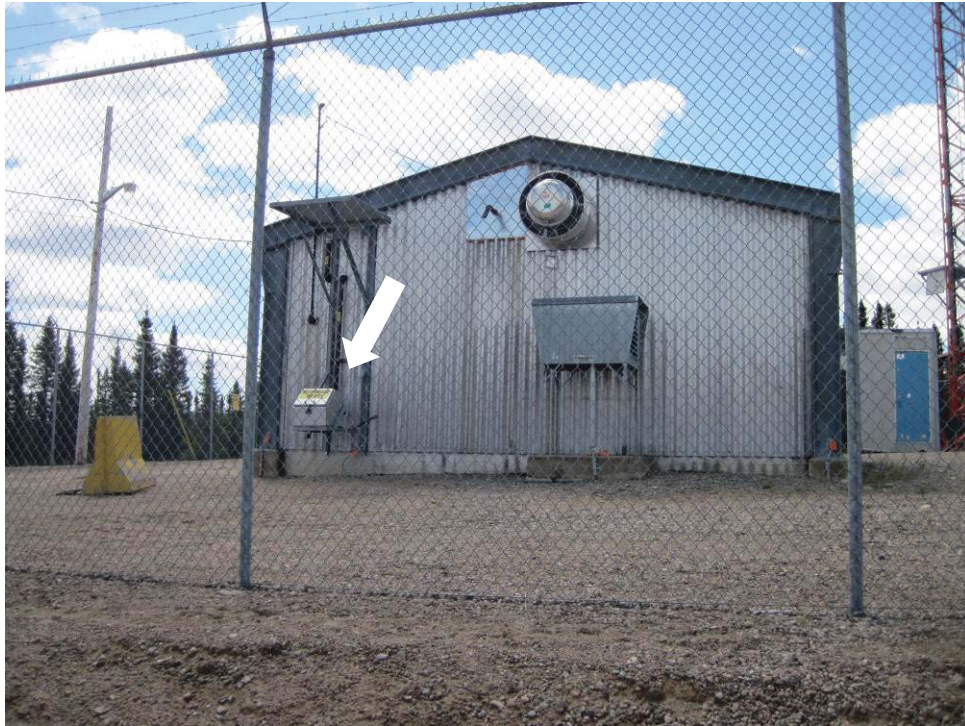
Photo 3 Station de télécommunications Nouvel d'Hydro-Québec au km 165. Boîte de remplissage de diesel à l'extérieur.
