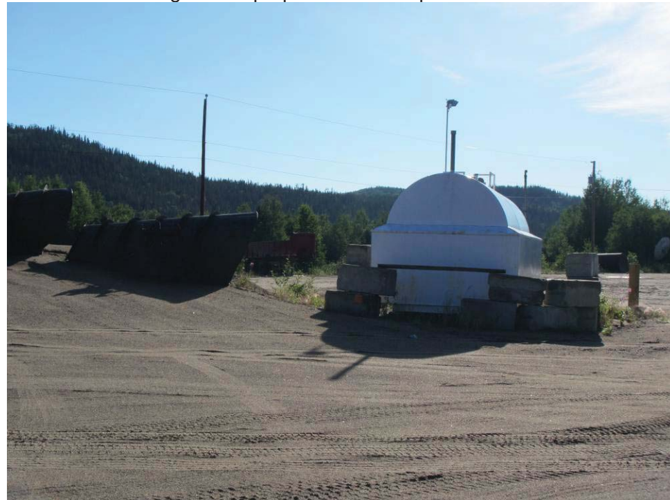
Photo 18 Réservoir hors sol de diesel sur la propriété de Transport Savard ltée au km 211.
