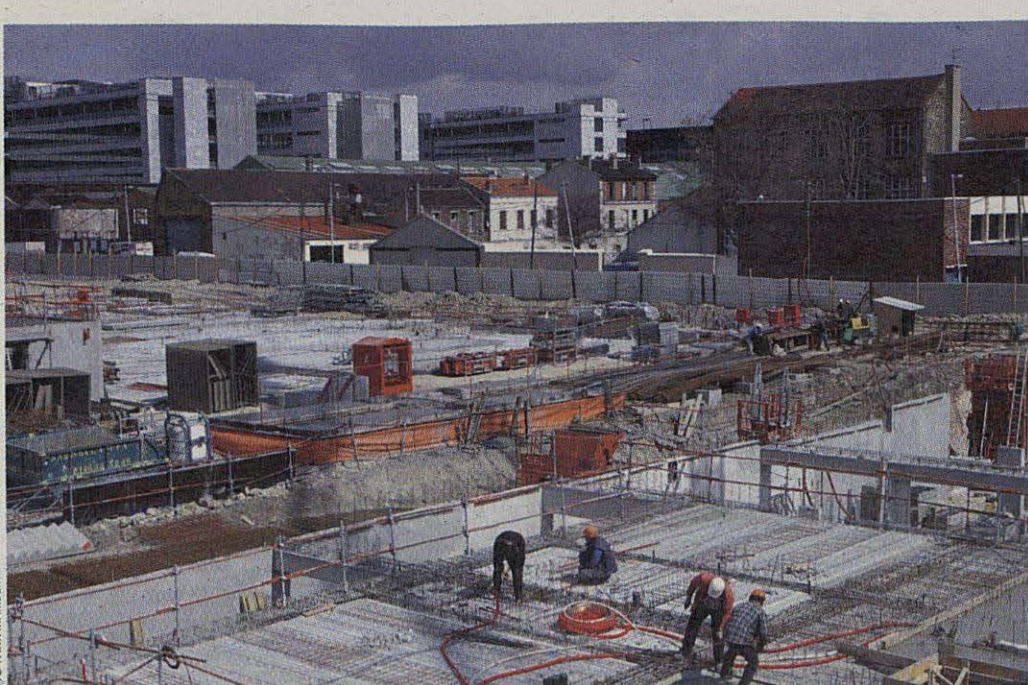
Les chantiers d'immeubles d'habitation, à deux pas de l'académie Fratellini, avancent sûrement.
