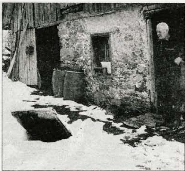
Betonska plošča dimnika je poškodovala streho Kežjarjeve domačije in "za las" zgrešila bodočo snaho Zdenka.
