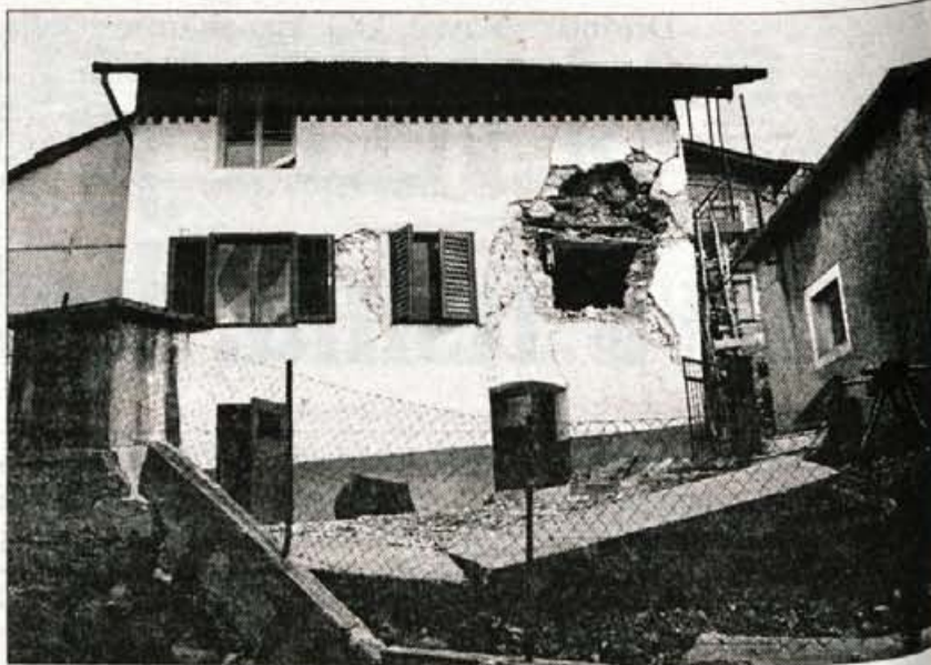
Okno je enostavno odneslo iz zidu
