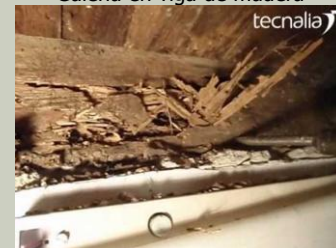
Daño severo en techo
