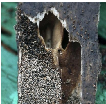
Fecas de termitas
