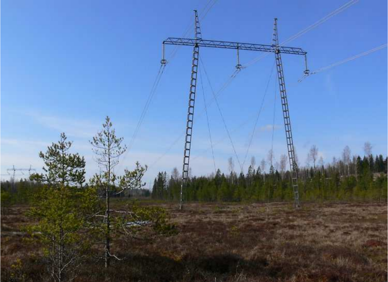
400 kV:n voimajohto (A2/A3) Ridajärven soidensuojelualueella, jossa laskettiin sekä paikallinen linnusto että tarkkailtiin lintujen lentoreittejä. Taustalla on A1-johto. © Seppo Niiranen
