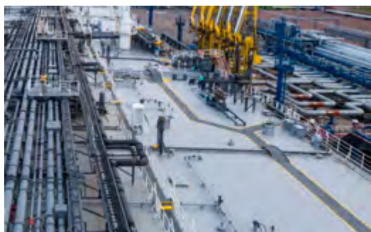
Ryc. 6.59. Zabezpieczenia tac awaryjnych
