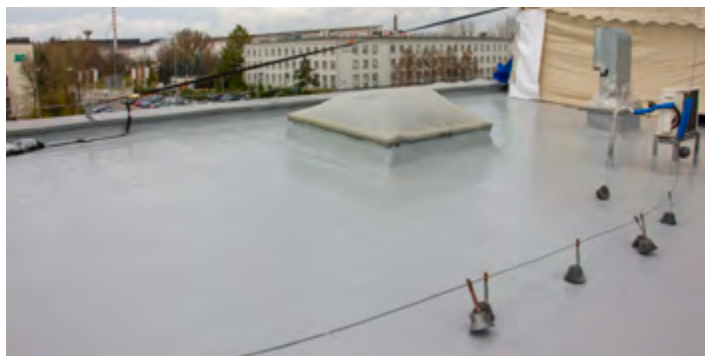
Ryc. 6.81. Instalacje odgromowe na dachu
