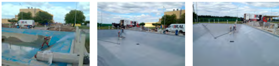
Ryc. 6.28. Zdjęcia z przykładowej realizacji prac nakładania powłoki wodochronnej MasterSeal M 689 podczas remontu zbiornika ppoż. w Płocku. Udostępnione przez: ERAL Usługi Techniczne
