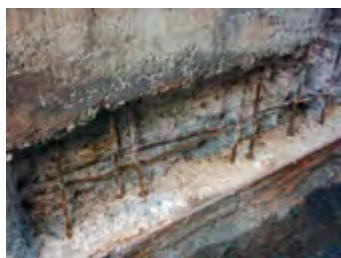
Ryc. 6.47. Skutki oddziaływania agresji mikrobiologicznej na żelbetową konstrukcję słupa
