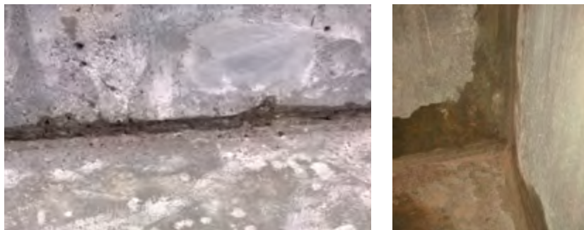
Ryc. 6.29. Przesączenie wody w miejscach przerw technologicznych
