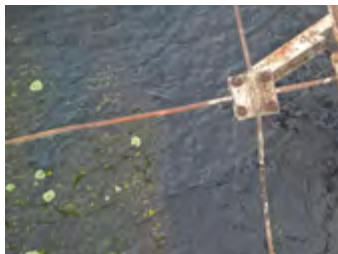
Ryc. 6.80. Uszkodzenia podłoża wykonanego z pokrycia bitumicznego. Przygotowanie do aplikacji powłoki
