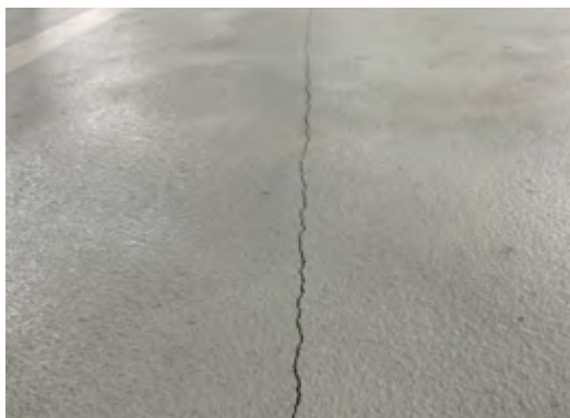
Ryc. 6.62. Pęknięcie na betonowej płycie parkingu
