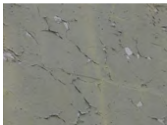
Ryc. 6.12. Delaminacja powłoki żywicznej wskutek zbyt wysokiej wilgotności podłoża w chwili aplikacji żywicy
