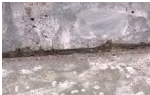
Ryc. 6.22. Przesączanie się wody w narożnikach
