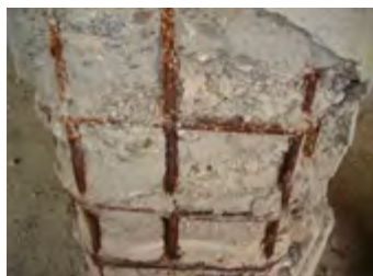
Korozja stali zbrojeniowej
