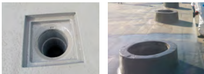
Ryc. 6.78. Ciągłość powłoki polimocznikowej na różnorodnym podłożu dachu. Udostępnione przez: ELIN Andrzej Juszczyk
