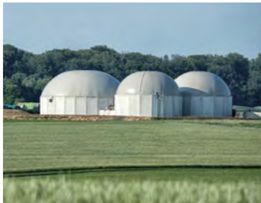
Ryc. 6.87. Komory fermentacyjne instalacji biogazowni rolniczej
