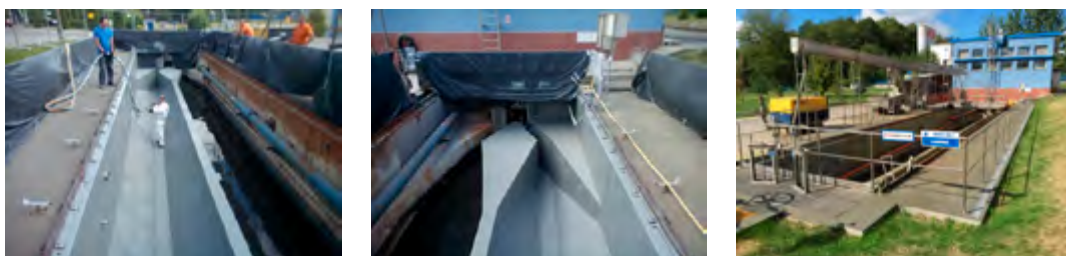
Ryc. 3.10. Zdjęcia z aplikacji powłoki MasterSeal M 689 wewnątrz piaskownika przy oczyszczalni ścieków komunalnych. Udostępnione przez: ELIN Andrzej Juszcak.
