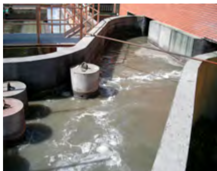
Ryc. 6.49. Faza mechanicznego oczyszczania wody
