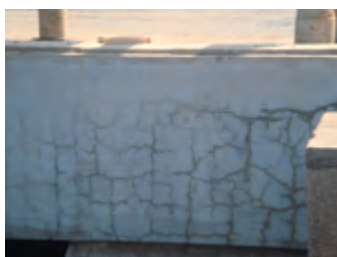
Ryc. 6.33. Rysy typowe dla konstrukcji zbiornika
