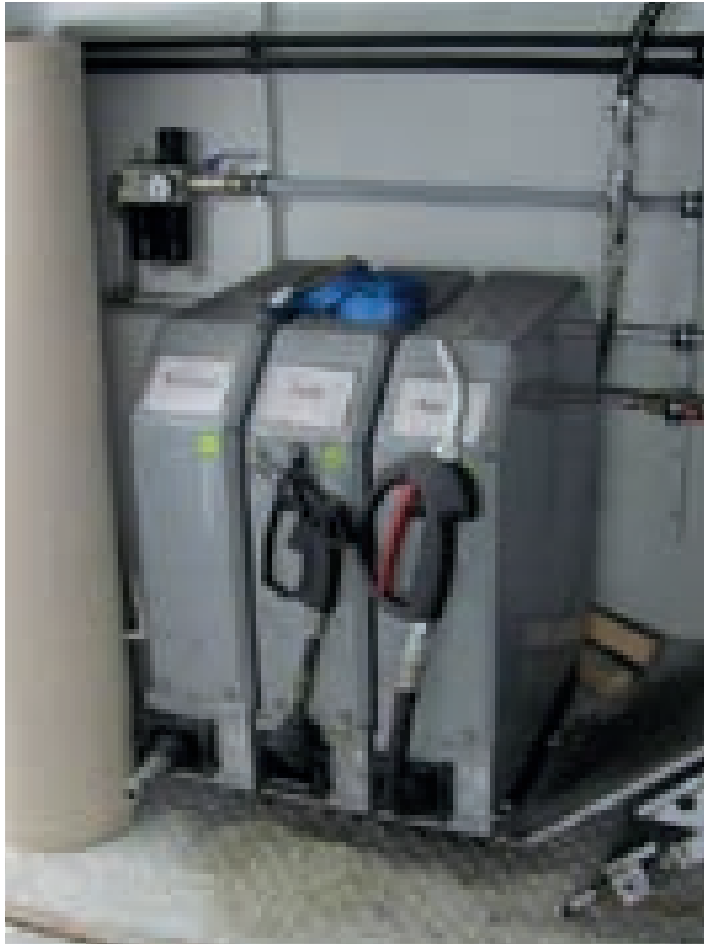
Schlauchaufroller in der Grube.
