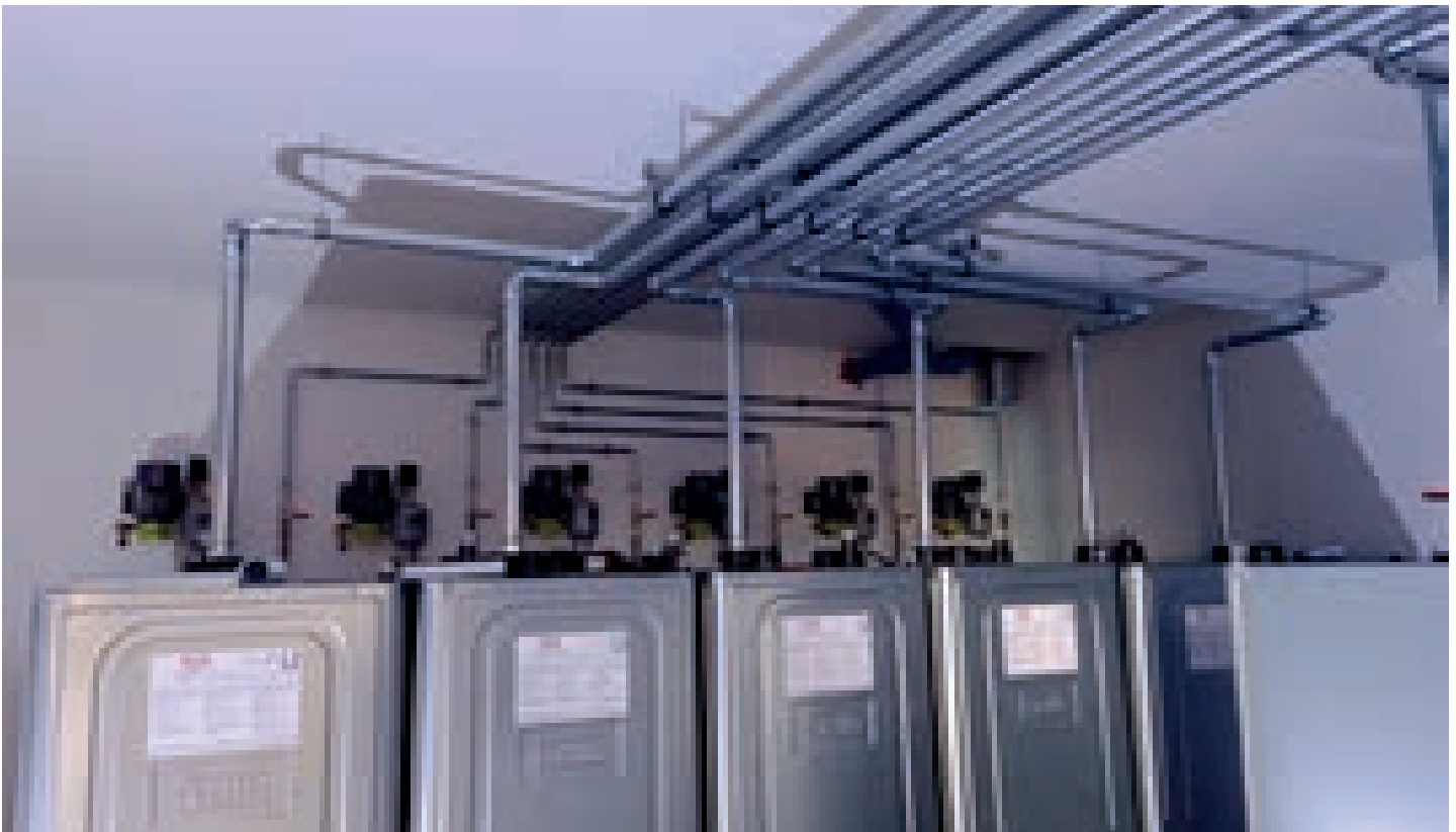
Tankraum mit kompletter Installation.
