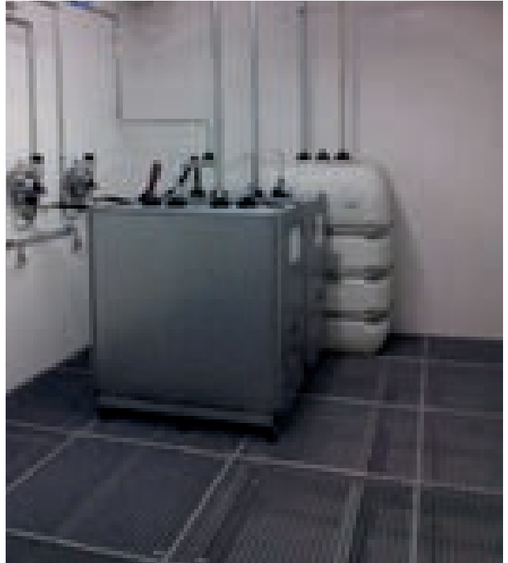
Tankraum mit kompletter Installation.
