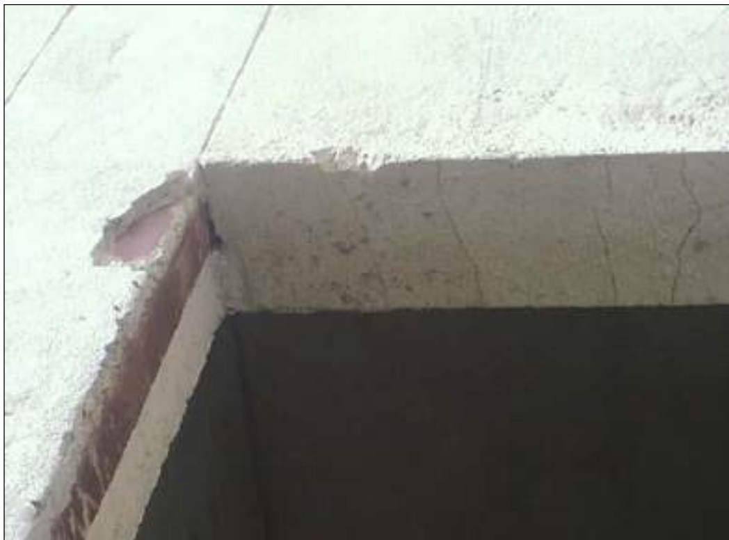
FIGURA 8: O revestimento não adería à estrutura metálica.
