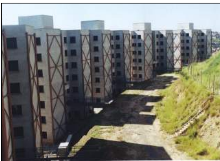
FIGURA 3: Vista do Conjunto Habitacional Brasilândia B23 na entrada da associação Comissão de Mães Formadas em canteiro de obra.
