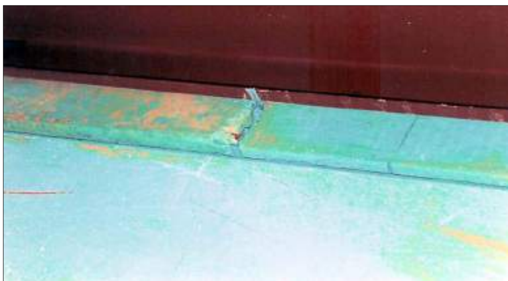
FIGURA 9: Foram identificadas também inúmeras lajes danificadas.
