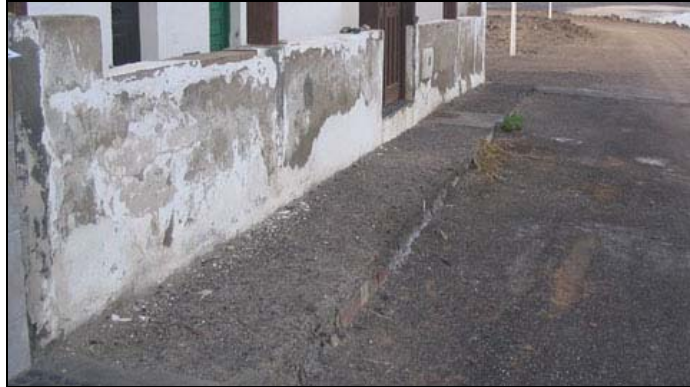
Efectos del oleaje sobre las fachadas de las construcciones en Pozo Negro (Fuerteventura). Fotografías tomadas durante la visita de campo.
