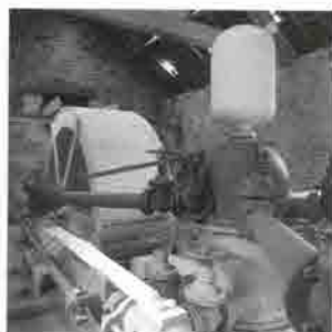
PORCHERESSE (Davernisse) – La machine à élever les eaux. Cliché Guy Focant, DPat, © MRW.
