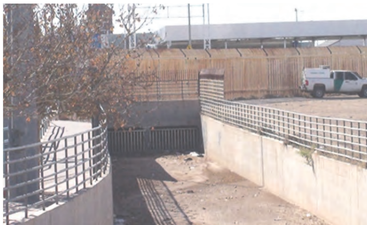
Canal de Concreto al este de la carretera Panamericana directamente al norte de la Frontera
