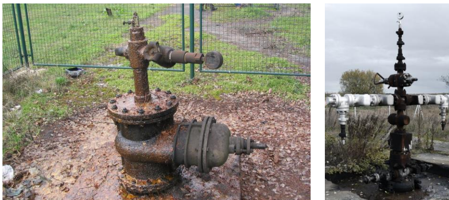
Slika 1.25 Primjeri izgleda nadzemne opreme geotermalnih bušotina (Gaurina, 2022.)
