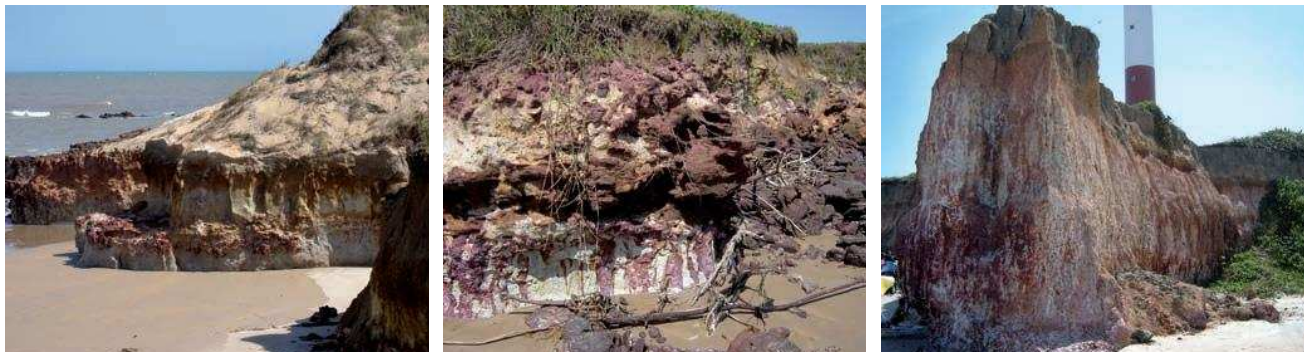
Figura 35 - Falésias da Formação Barreiras na praia da Barra de Itabapoana (Foto: Maria da Glória Alves).
