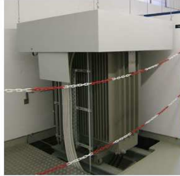
Abschirmhaube über einem Transformator.
