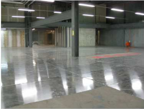
Abschirmung eines Bodens gegen die magnetischen Felder einer darunter liegenden Hochspannungsschaltanlage.
