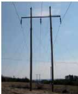
Vindparker ansluts vanligtvis med en 130 kV luftledning med 12 - 18 m höga trästolpar och 40 m bred ledningsgata
