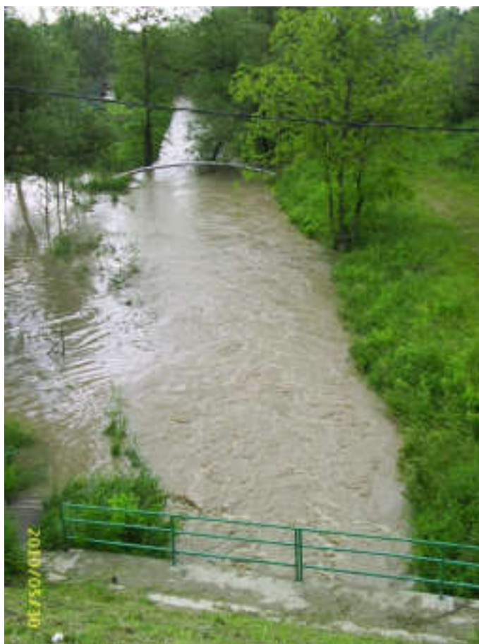
A Balatoni úti felüljáró alvízi oldala, a korlát alatt található az áteresz nyílása (forrás: FCSM ZRt.)
