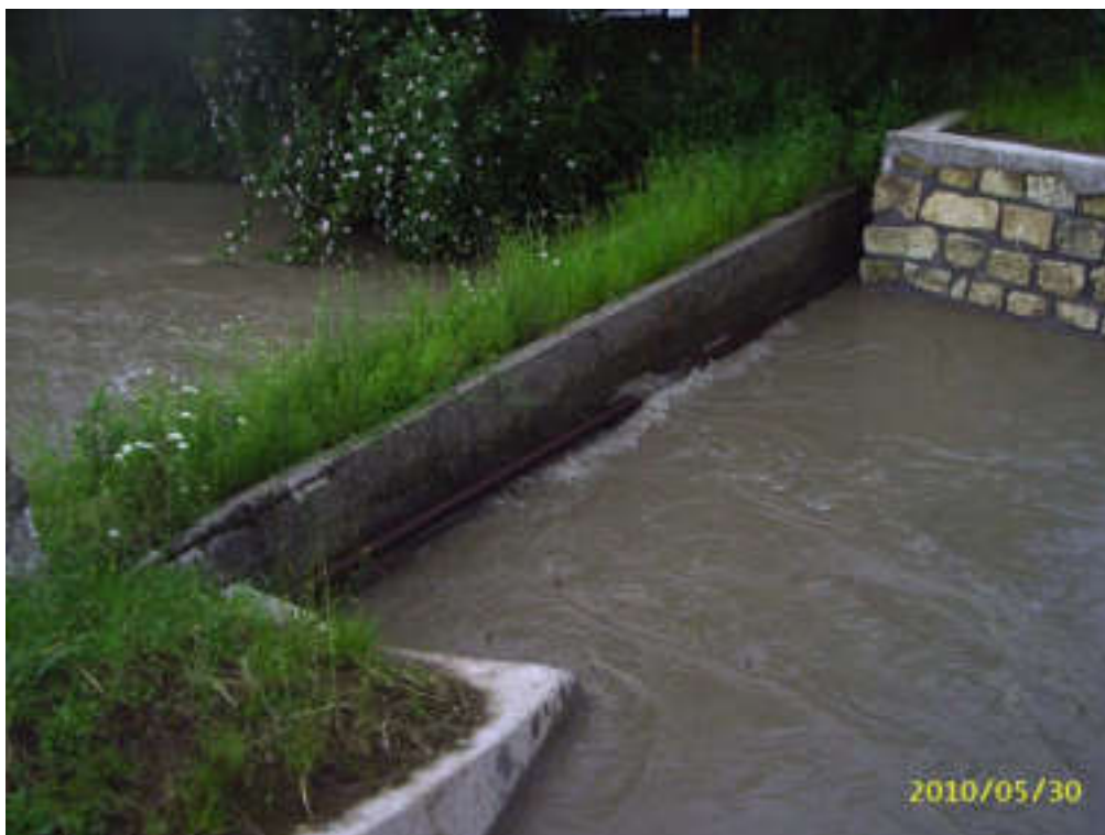
Visszaduzzasztó közműátvezetés a Péterhegyi út közúti hídja alatt (forrás: FCSM ZRt.)
