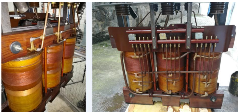
Figura 2.14. Conjunto núcleo-bobinado del transformador bajo prueba.
