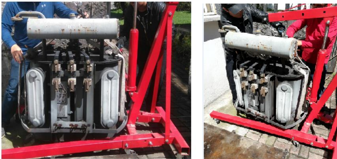
Figura 2.1. Transformador encontrado junto al edificio de Ciencias Básicas EPN.
