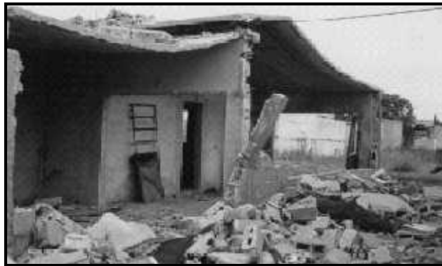
Figura 1-14 Destrucción por efectos de la explosión. Fuente: Grupo MARTE ESING.
