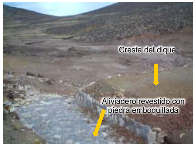
Aliviadero microrrepresa Ccacasuico, Chalhuanca, Caylloma.
