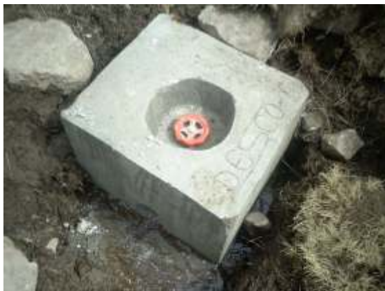
Caja de seguridad de válvula.
