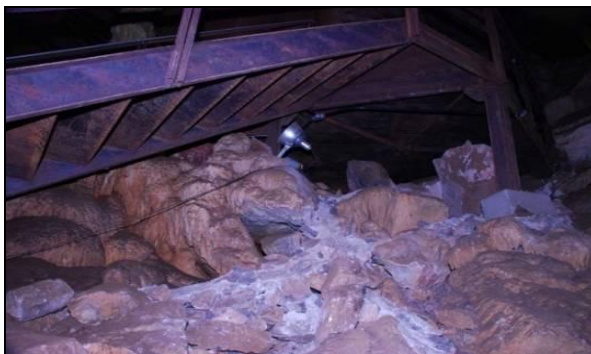
E – Cordões de argamassa e blocos para ocultar cabeamento elétrico. Neste local todo o cabeamento e luminárias poderiam ter sido instalados na passarela, sem impactos diretos para a caverna. Local: “Salão dos Blocos desabados”. Foto: V. Moura.
