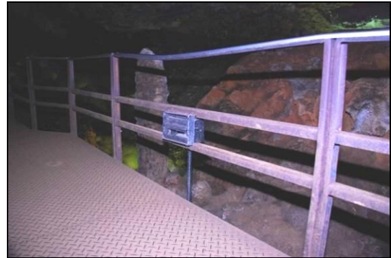
B – Trecho da passarela, no Salão das Raridades, com corrimão danificado por corrosão e deformação. Foto: V. Moura.
