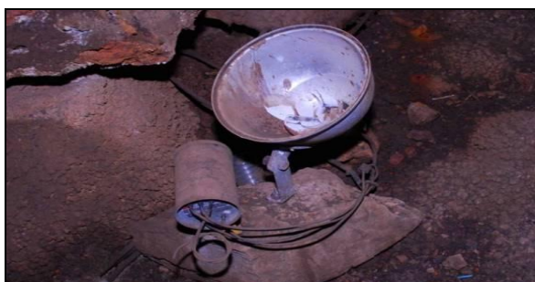
A – Exemplo de refletor, com lâmpada quebrada, sem o vidro de proteção e com o respectivo reator ainda ligado. O sistema pode estar energizado, podendo oferecer risco para os responsáveis por sua manutenção e para a fauna cavernícola. Local da foto: Próximo ao Lago Suspenso. Foto: V. Moura.
