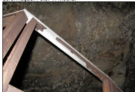
D – Vista do perfil de aço corroído (perfil de cor marrom, na foto), sob o corrimão de alumínio (perfil de cor cinza claro, na foto), apresentando pontas cortantes. Foto: V. Moura.
