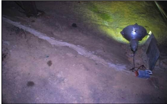
A – Instalação de cordão de argamassa aderido à capa estalagmítica, com o intuito de ocultar o cabeamento elétrico. Foto: V. Moura.
