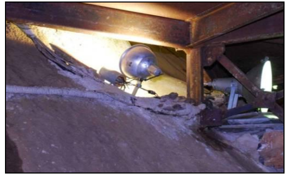
D – Eletroduto e luminárias instaladas sobre espeleotema. Neste local, os eletrodutos e luminárias poderiam ter sido fixados sob a passarela. Local: próximo ao Lago Suspenso. Foto: L. Alt.
