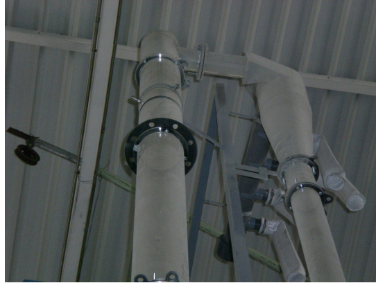
Foto 4. Vista de la zona alta del riser y del ciclón
