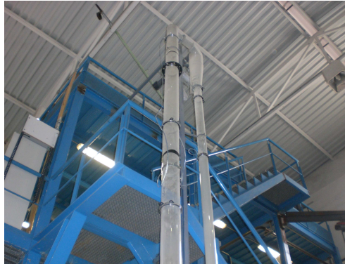
Foto 1. Vista del reactor a pie de planta
