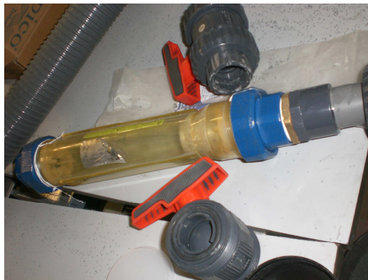
Foto 13. Rotámetro de aire comprimido
