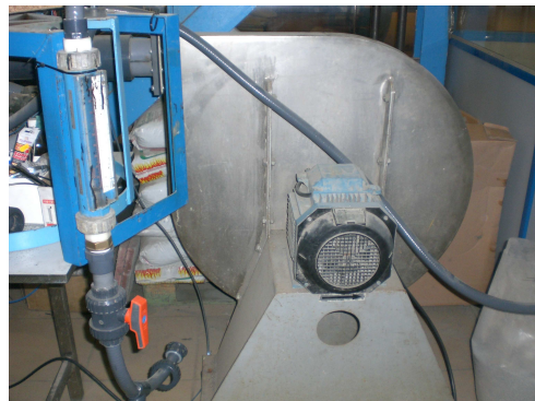
Foto 2. Ventilador secundario y rotámetro de aire comprimido
