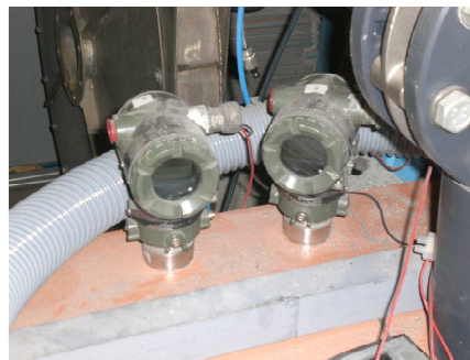
Foto 11. Medidores de presión
