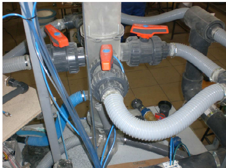
Foto 8. Tramo secundario conectado al riser
