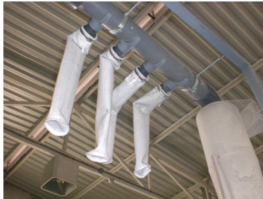
Foto 5. Salida del ciclón hacia el exterior con las mangas dispuestas
