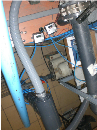
Foto 7. Medidores de flujo y ventilador primario junto con el tramo primario
