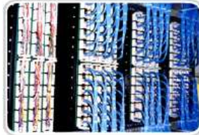
Patch panels UTP en un bastidor
