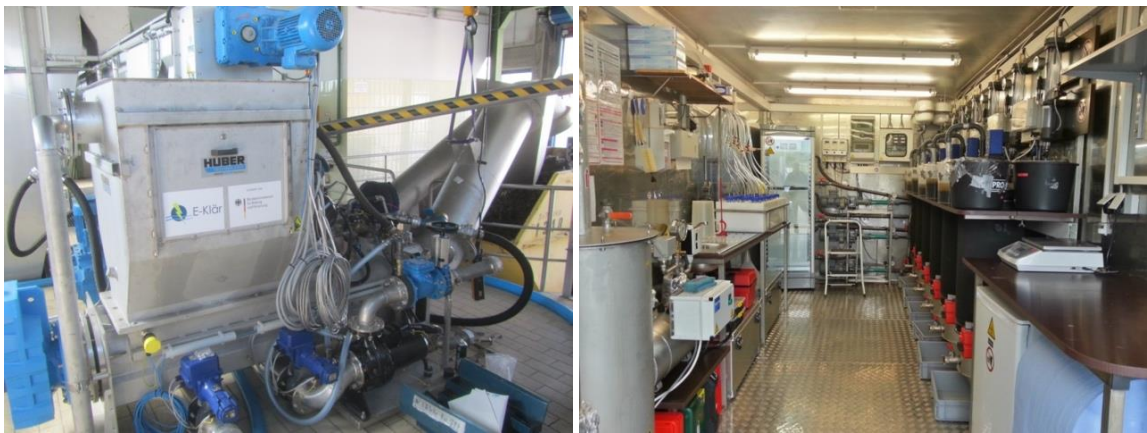
Abbildung 1: Rechengutwaschpresse und Anaerobreaktoren
