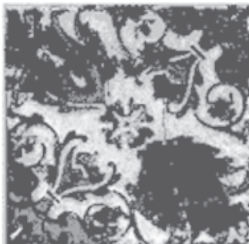
Fig. 6 – Azulejos com manchas provocadas por colônias de cianobactérias
