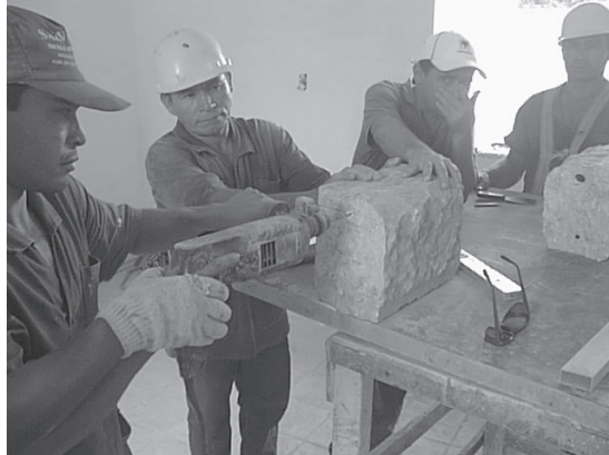
Fig. 3 – Emenda em bloco de Lioz com resina epóxi. Obra de restauração do Antigo Presídio S. José, Belém do Pará.
