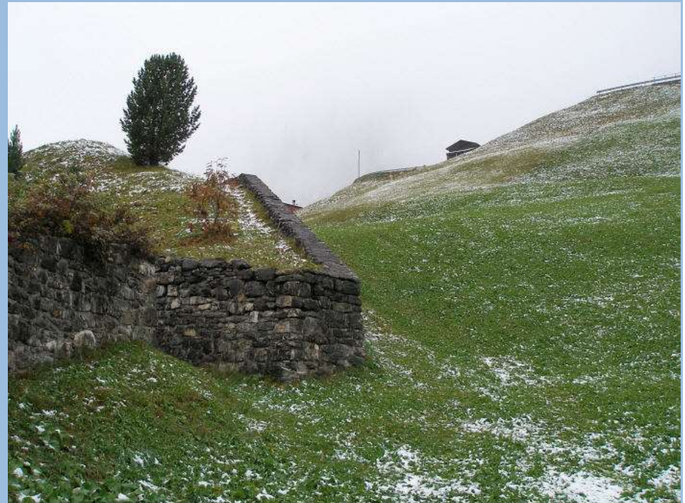
St. Antönien (Graubünden), Lawinenschutzmauer. Foto: SLF
