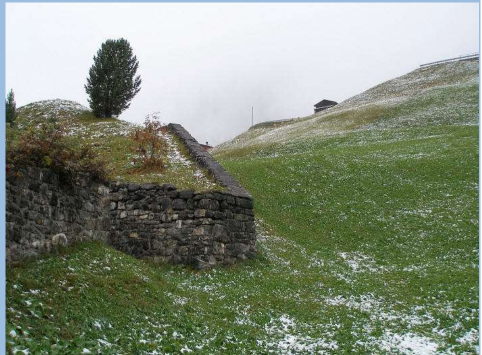
St. Antönien (Graubünden), Lawinenschutzmauer. Foto: SLF
