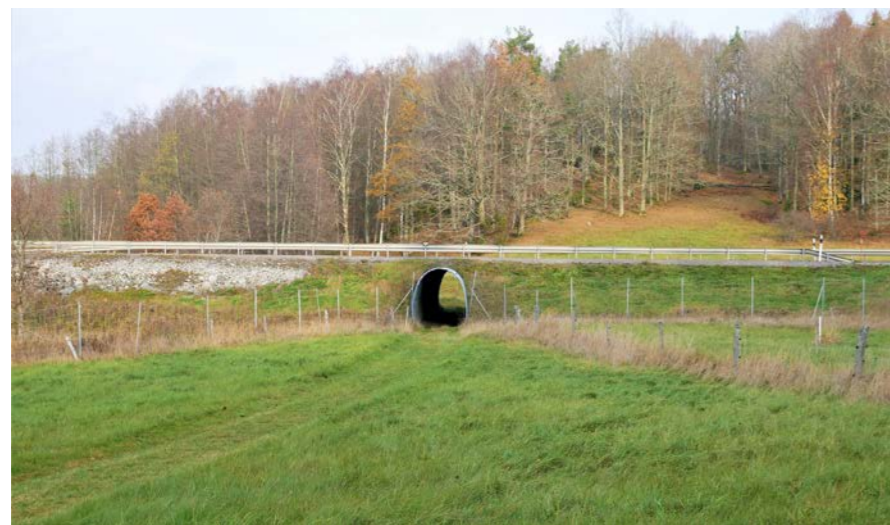
Figur 6.1.6. Passage för boskap, koport i form av en rörtunnel, vid Lissma. Foto: Tyréns.
