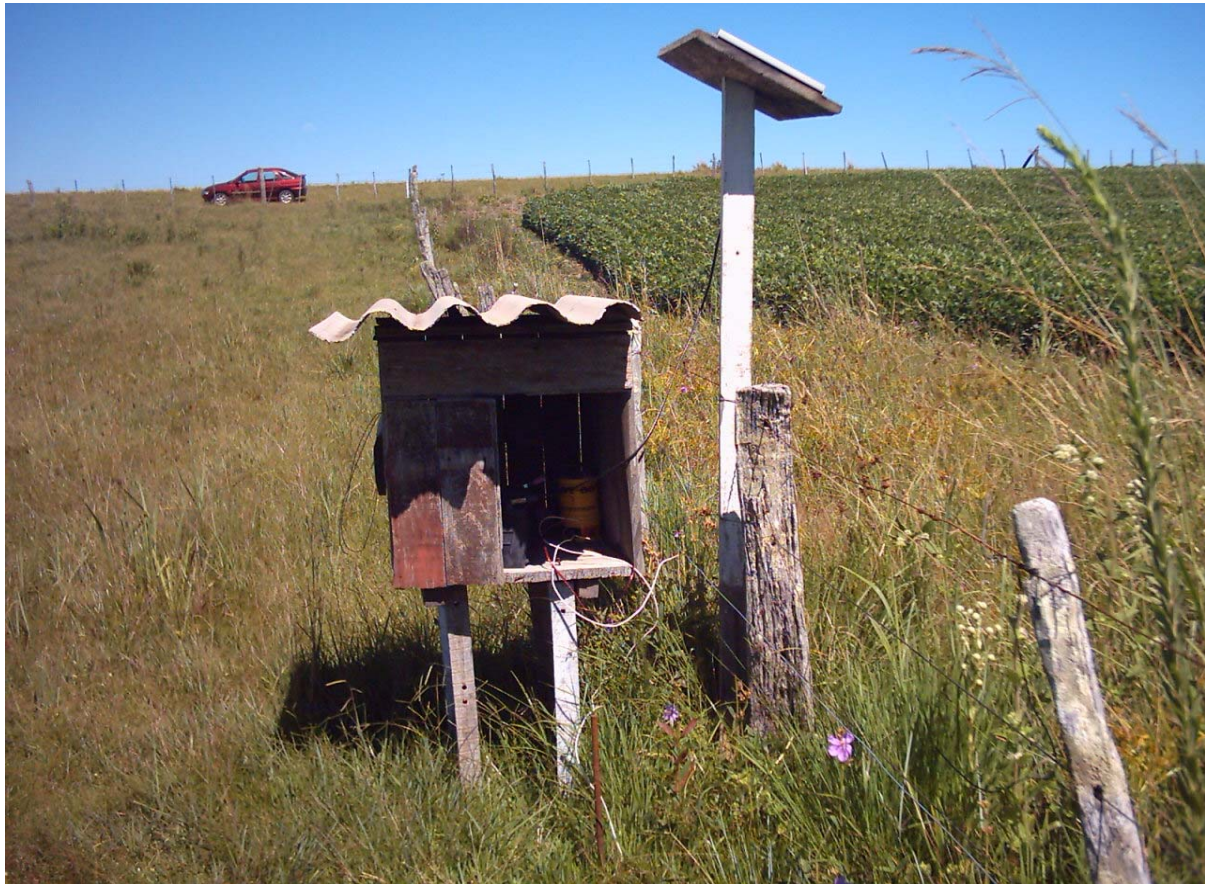
1-Potrero número uno donde están los monitores eléctricos, las placas de células fotovoltaicas y el acumulador de energía.
