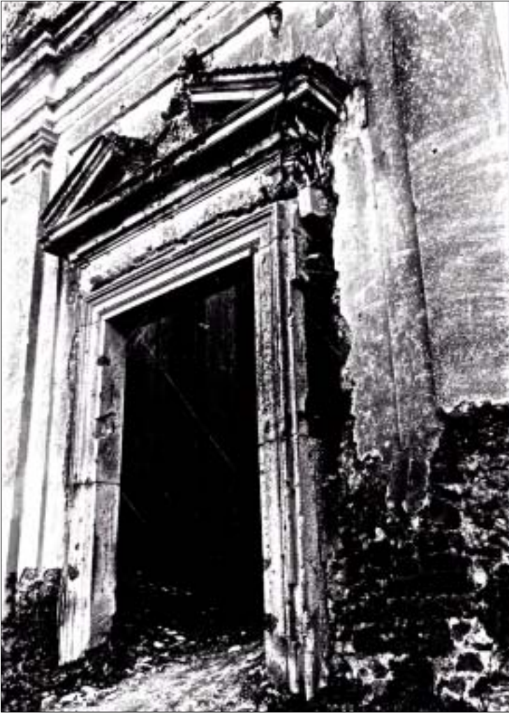
[12] L'ingresso della chiesa di San Bonaventura di Monterano, prima dell'intervento di restauro.
