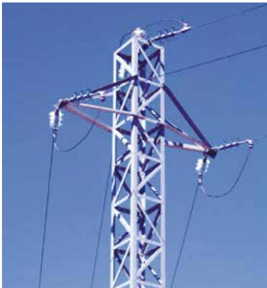
Suport elèctric amb connexions superiors de risc d'electrocució molt alt. (Fotografia: D. Guinart)
