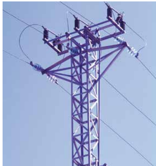
Suport amb interruptors horitzontals de risc molt alt d'electrocució. (Fotografia: D. Guinart)
