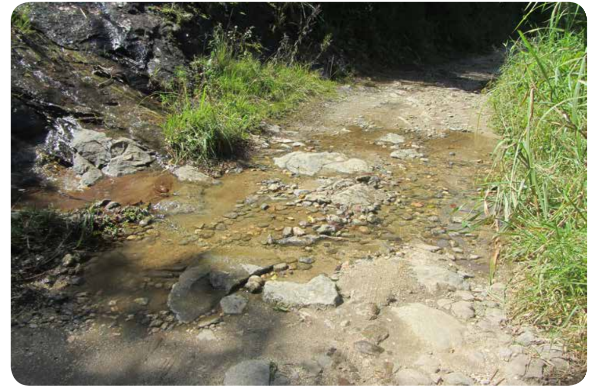
Exemplo de curso d'água atravessando a estrada sem drenagem.
