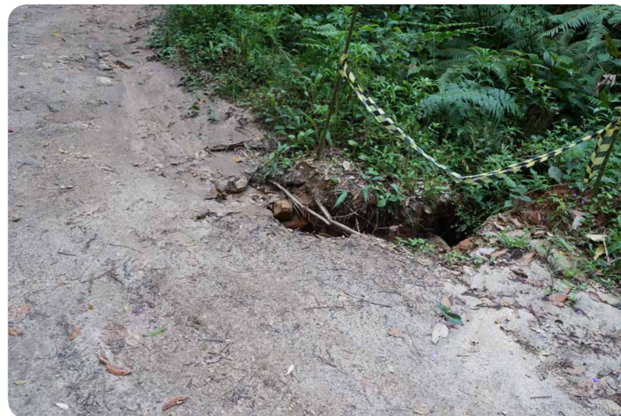
Risco de desmoronamento lateral da estrada por falta de drenagem.
