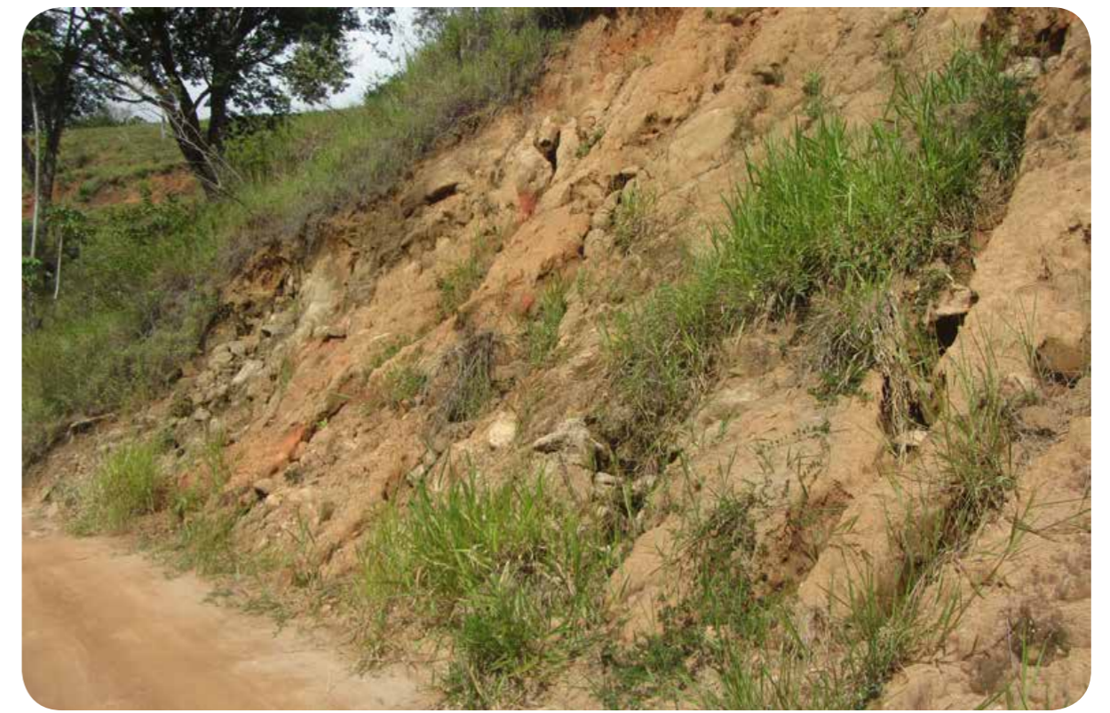
Sulcos erosivos em talude.
