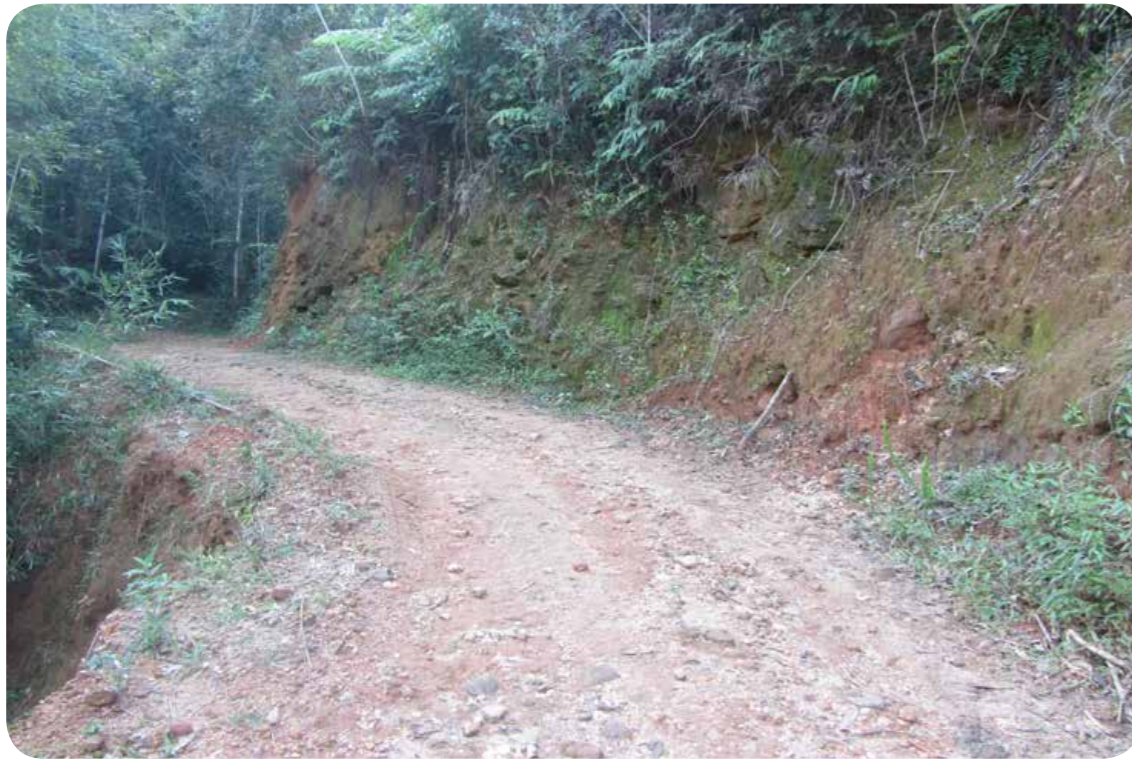
Exemplo de erosão leve no talude, com risco de desmoronamento da estrada.
