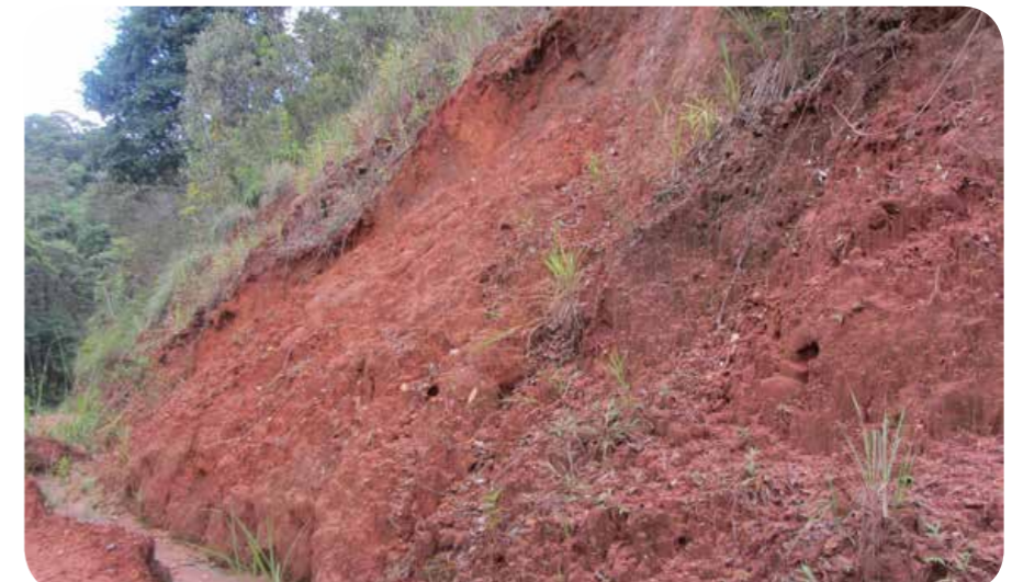
Área com desbarrancamento de talude e movimentação de massa.
