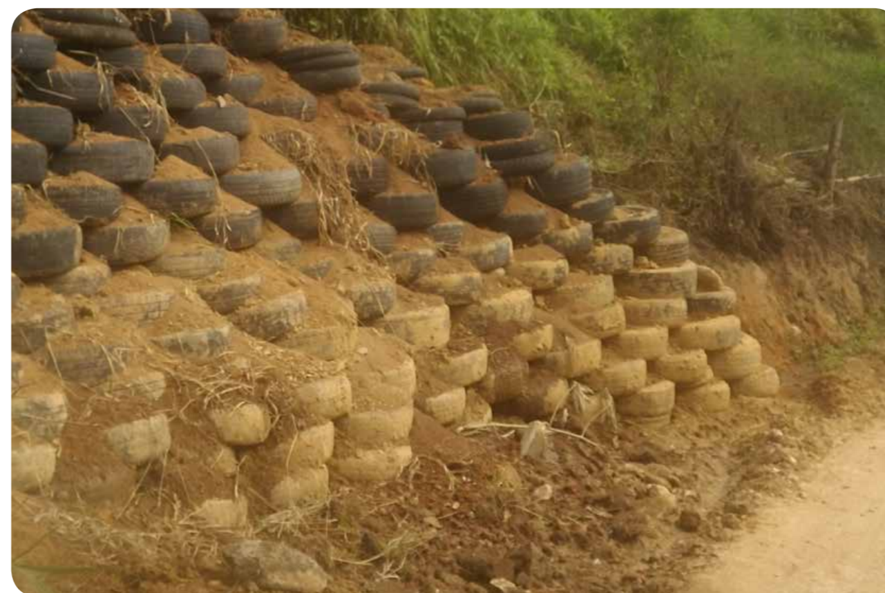
Ponto de processo erosivo em contenção por iniciativa de moradores locais.
