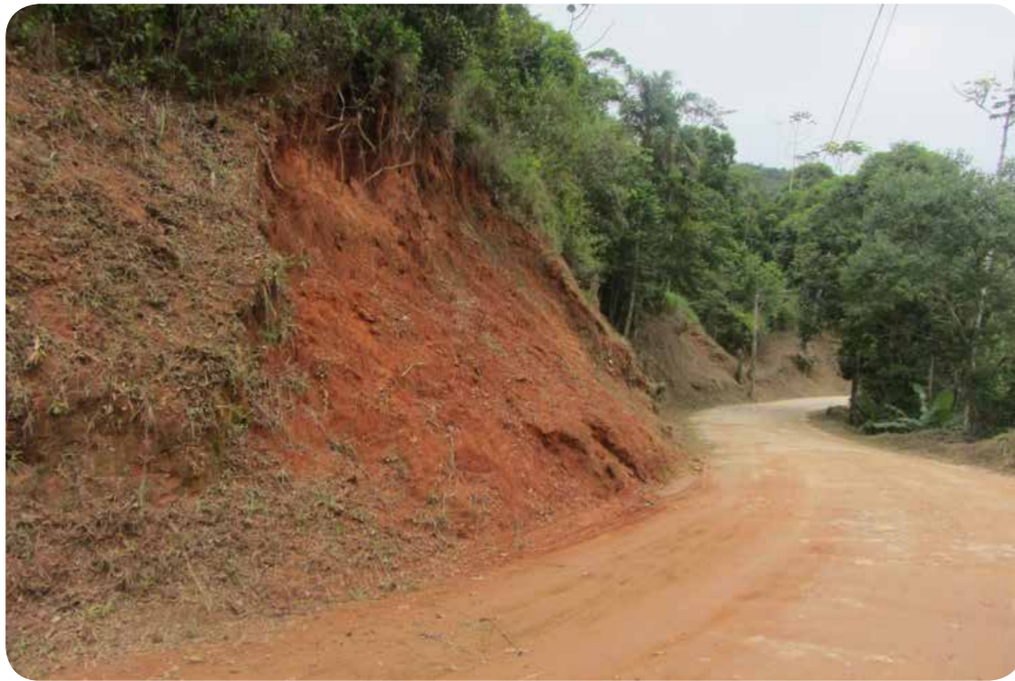
Exemplo de erosão leve à moderada no talude.
