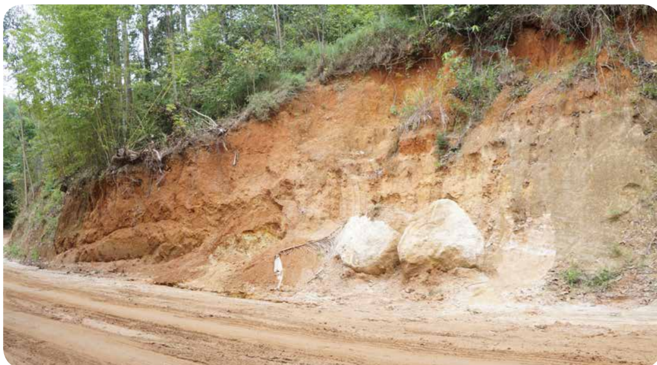
Área de talude com risco de movimentação de massa, na FRI 107.
