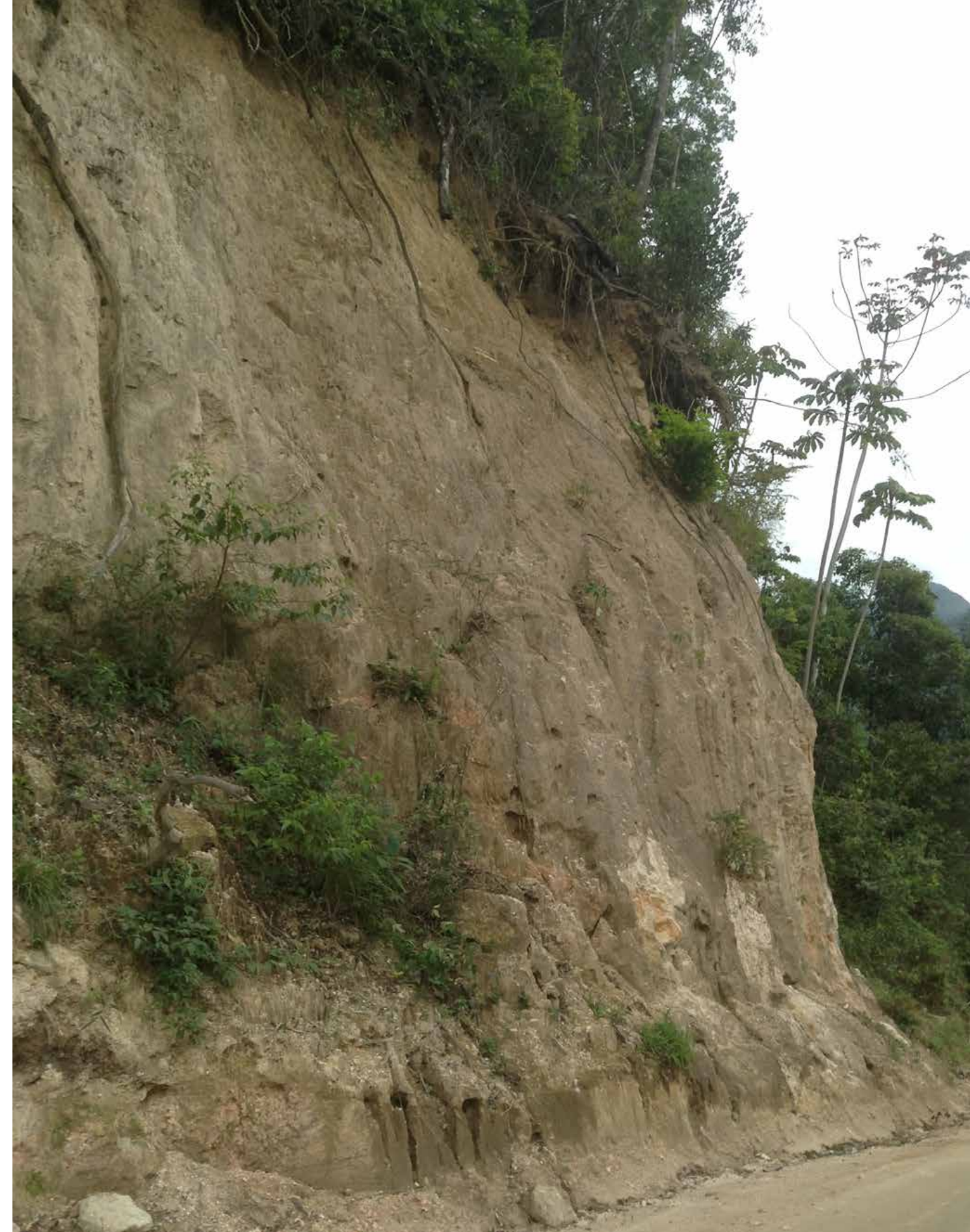
Corte em talude de estrada, com evidência de processos erosivos atuantes e risco de queda de árvores.
