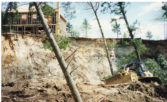
Figure 14 | Glissement de terrain provoqué par des opérations de remblayage
