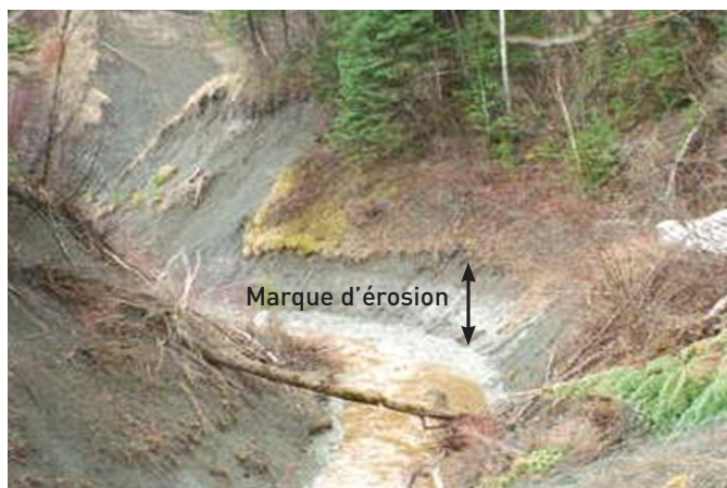
Figure 4 | Marque d'érosion à la base d'un talus
