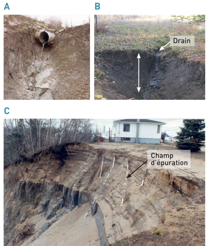
Figure 20 | Exemples d'interventions qui ont pour effet de provoquer une concentration d'eau pouvant nuire à la stabilité d'un talus : A) ravinement provoqué à la sortie d'un ponceau; B) érosion verticale provoquée à la sortie d'un drain; C) infiltration d'eau dans le sol due à un champ d'épuration
