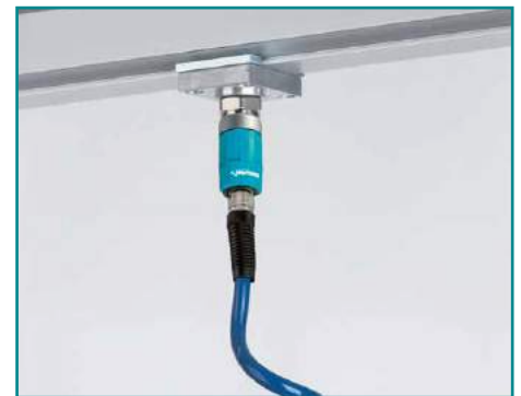
Fertig montierter Druckluftanschluss mit Sicherheitskupplung und Spiralschlauch.
