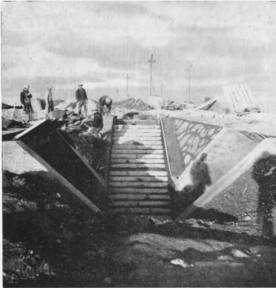
Paso subterráneo para peatones en una de las grandes avenidas del Polígono.
